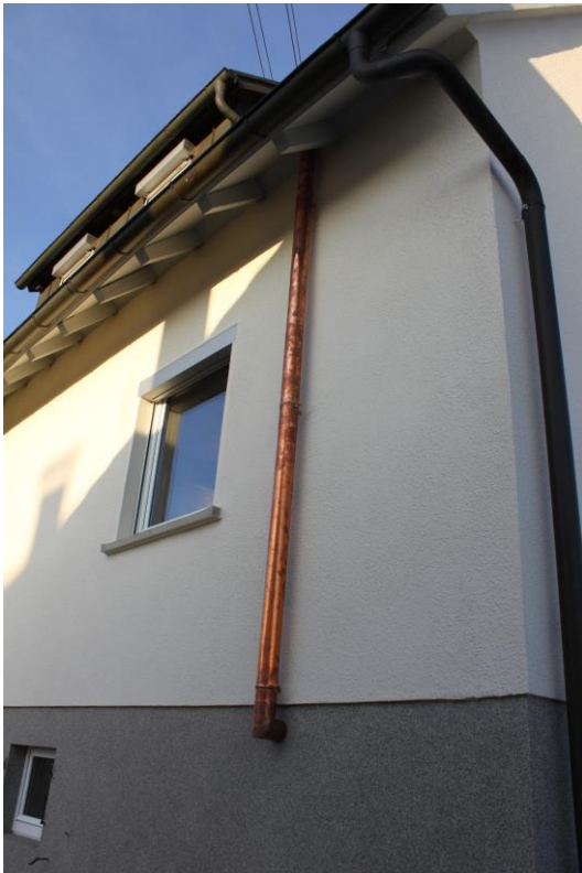
Verbindungsleitung vom Speicher zur Solaranlage
